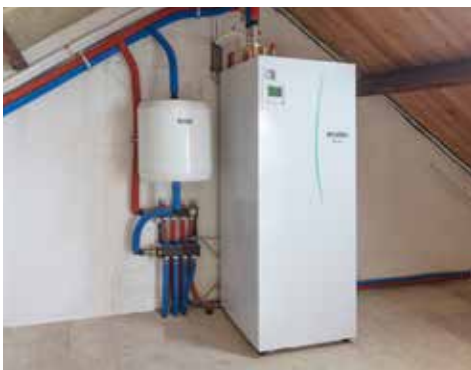
Voorbeeld van een cilinderunit-opstelling met (ingebouwd) 200 liter boiler en een 40 liter buffervat.
